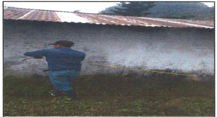
Foto 4: La pared de la cocina y parte del techo.
